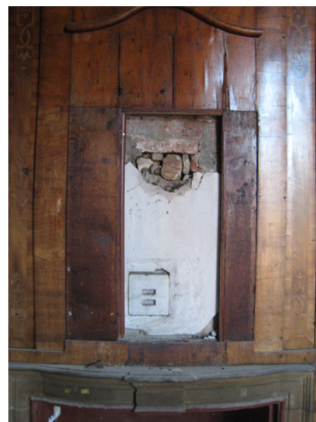
11 Intarsienkabinett, südöstliche Wand, über dem Kamin ein größerer Verlust in der Vertäfelung
